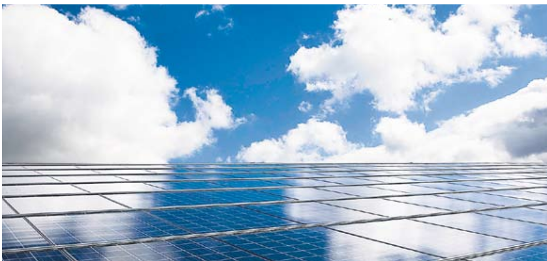
Bild: energiebüro® ag für Solarkraftwerk
