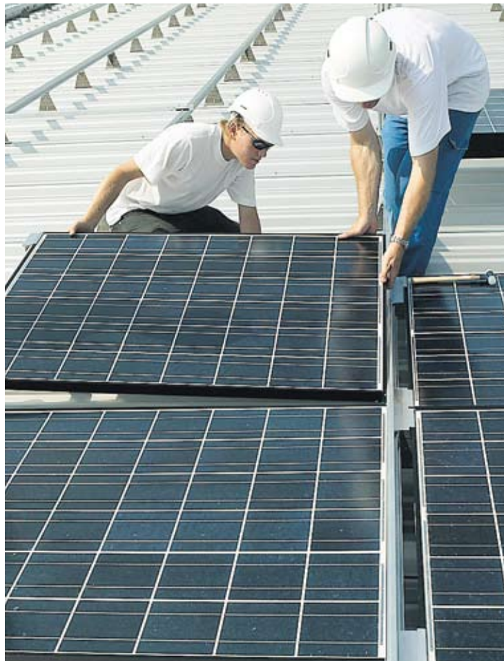
Bei der Briner AG in Winterthur werden auf der Werkhalle 1050 Fotovoltaik-Module installiert werden. Bild: energiebüro® ag für Solarkraftwerk
