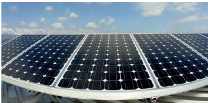
Die 1650 Solarpanels (rund 2000 m 2 ) auf dem Hangar des Flughafens Genf repräsentieren die zweitgrösste Solaranlage in der Schweiz.
